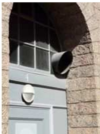
1. Outside Vattenporten 6 aeration system
